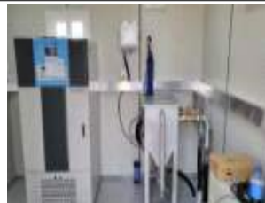
<통합관측소 내부 전경>
