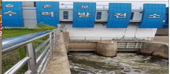
#1호기+#2호기 방류구 전경
