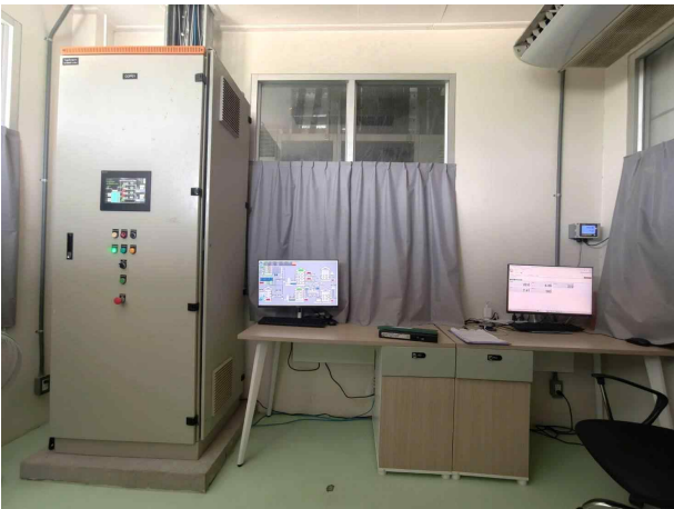
로컬 SCADA 구축현황
