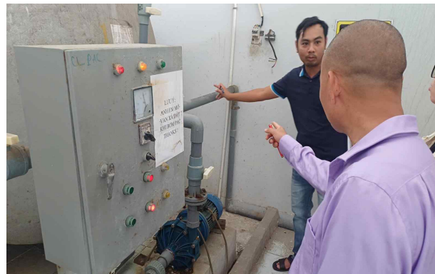
PAC 주입설비 점검(개선방안 마련)
