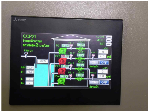
로컬 SCADA 화면
